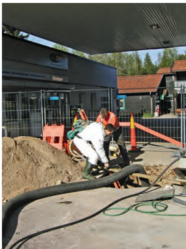
Återkommande kontroll av cisterner i mark
