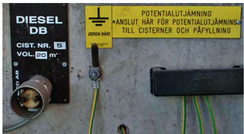
Anslutning för potentialutjämning mellan fordon och cisterner
