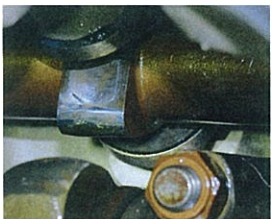
Brent ventil: Den grønne fargen i venstre underkant viser at det har vært en lekkasje med påfølgende overoppheting.
